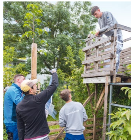
Arbeiten am morschen Kletterturm.
